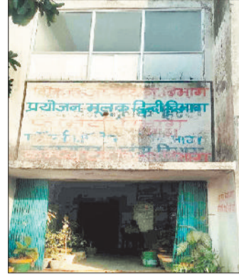
शैक्षणिक विभाग का जर्जर भवन।
